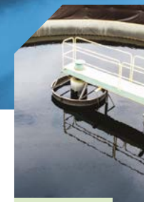
Tratamento de Efluentes e Afluentes
