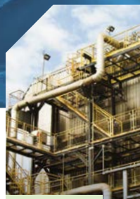
Geração de Vapor
